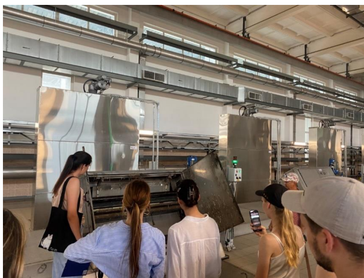
Рис. 3 – Решетки механической очистки
